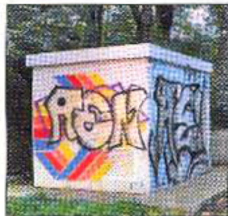
Die beschmierte Stromstation vor der neuen Gestaltung.
